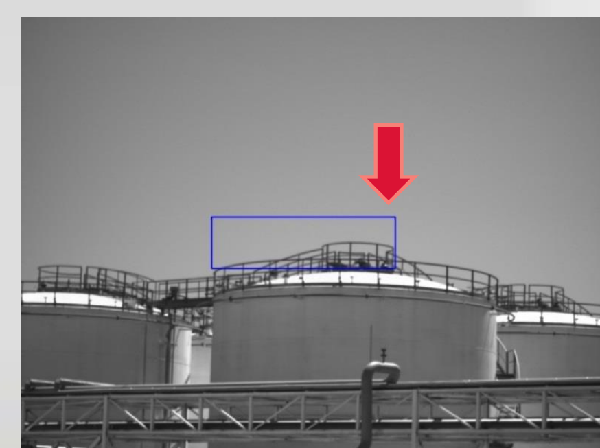
Figure 5 : Soupape sur le toit d'un bac lors du chargement d'un bac par un navire – image visible vue depuis le sol.
